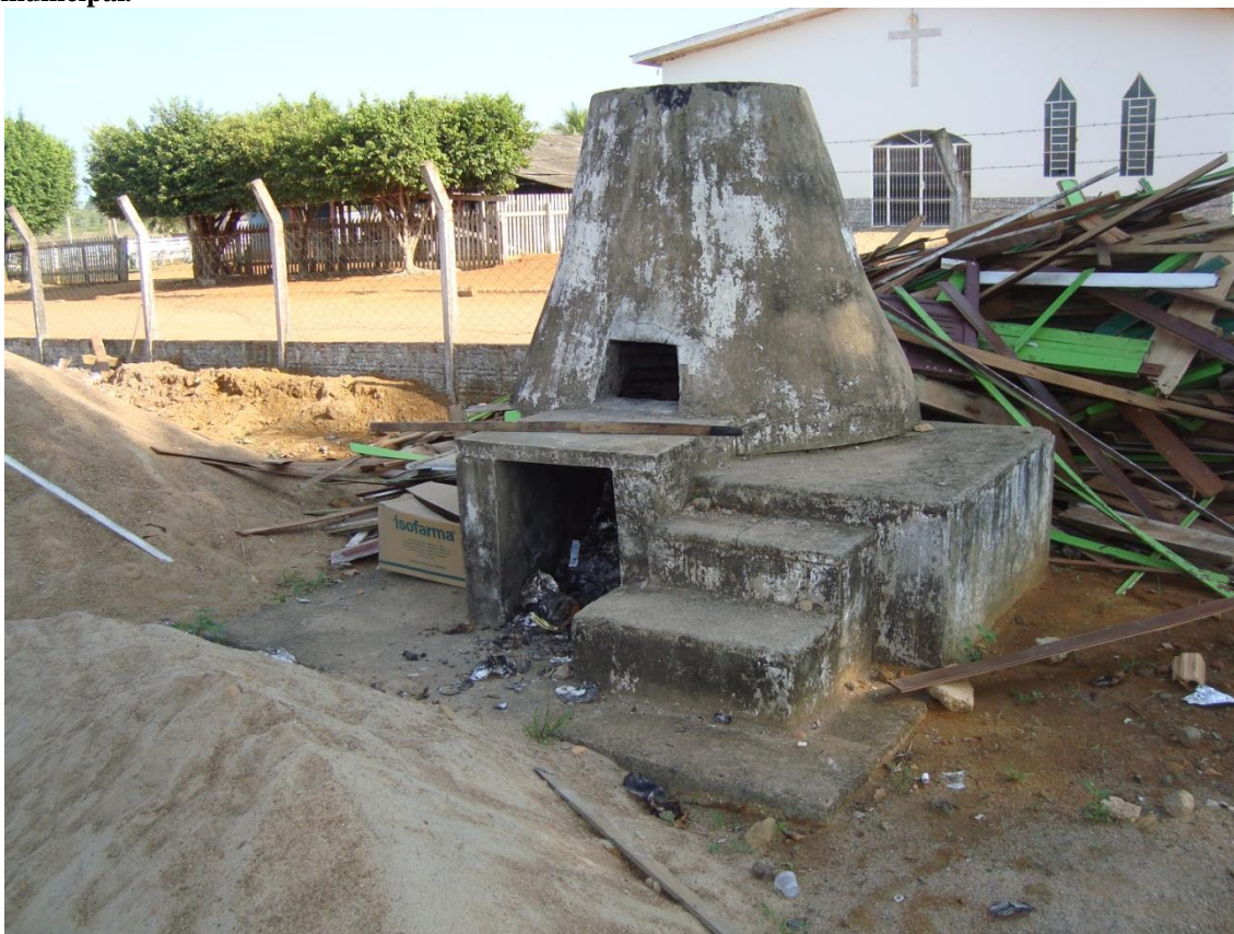
Imagem 43 – Vista do incinerador do lixo hospitalar localizado nos fundos da unidade de saúde municipal.
