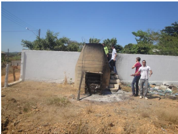
Foto 107: Detalhe do forno utilizado na incineração de resíduos sólidos de saúde.
