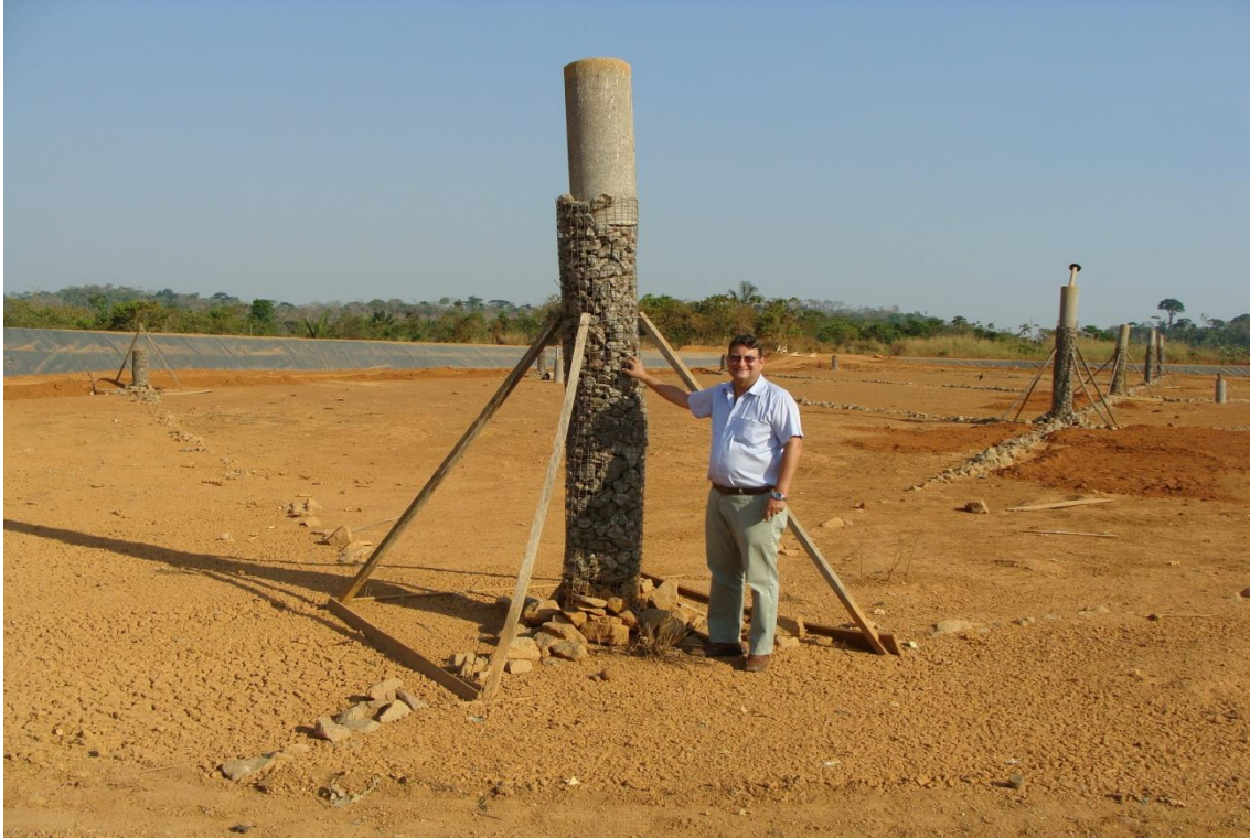
Imagem 15 - Detalhe do dreno de gases no primeiro plano e manta bidin (manta impermeabilizante no segundo plano)
