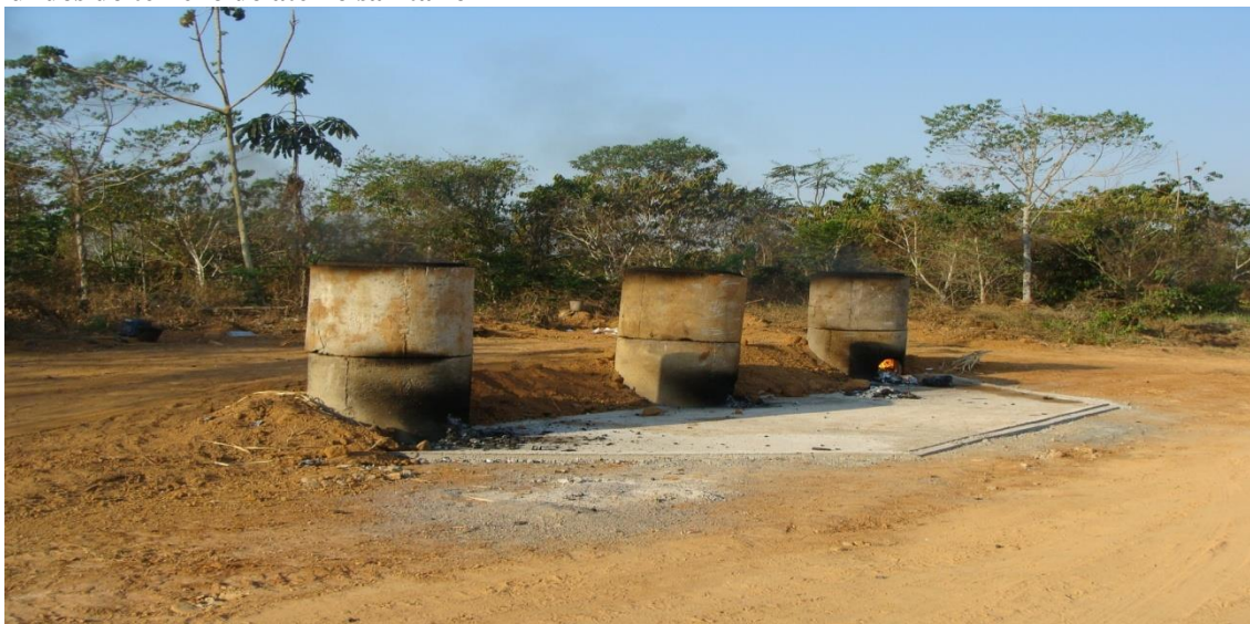
Imagem 1 – Vista dos três fornos provisórios de incineração dos resíduos sólidos de saúde nos fundos do terreno do aterro sanitário
