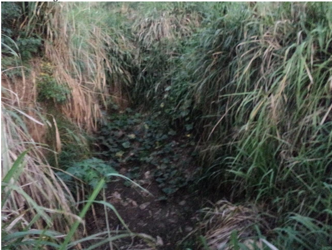
Imagem 41 – Detalhe da vala negra onde são depositados os resíduos de natureza líquida oriundos do esgotamento de fossas domiciliares
