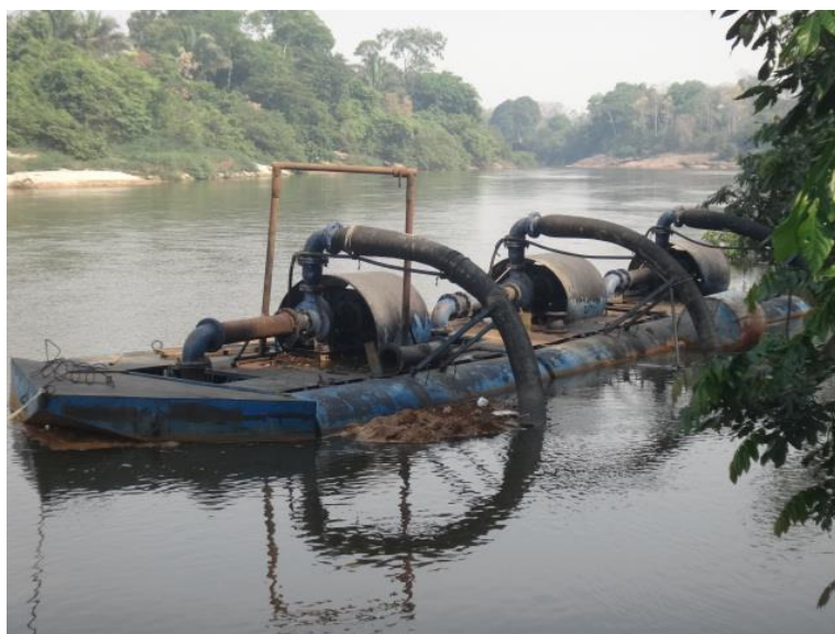
Figura 9. Captação de água do SAA da CAERD em Ariquemes. Fonte: E.C.P. Soluções (2016).
