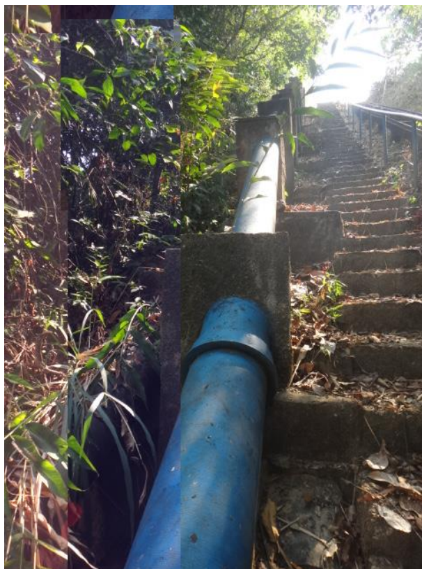
Figura 10. Linha de adução de água bruta. Fonte: E.C.P. Soluções (2016).
