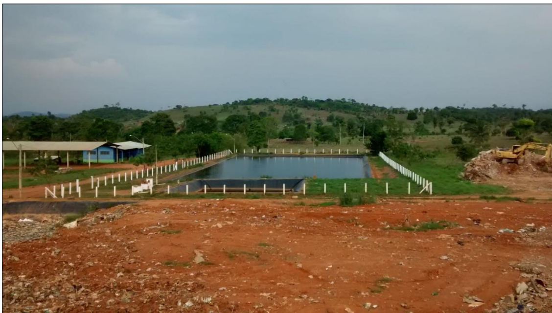
Figura 29. Visão geral do sistema de tratamento de lixiviados.
